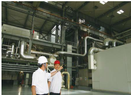
熱電供給設備
